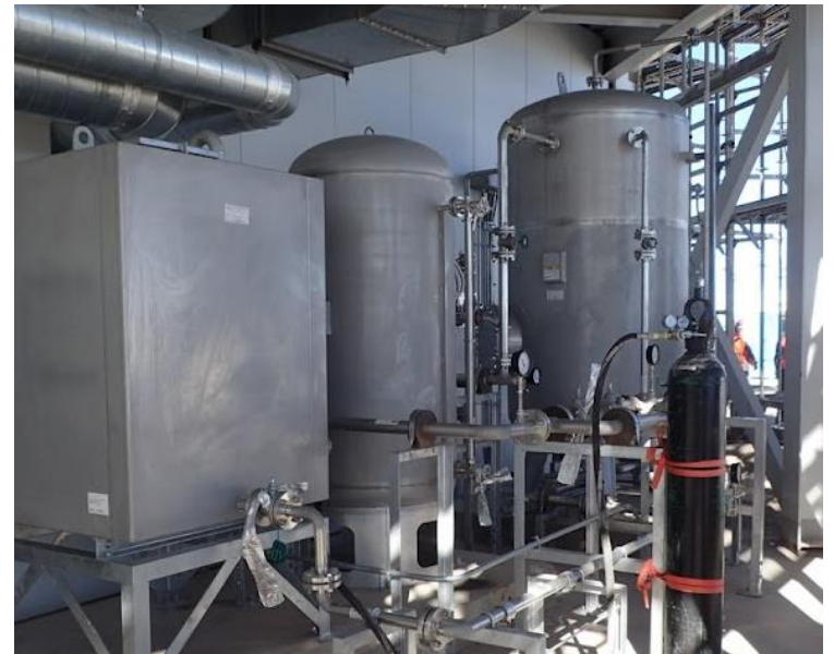
冷却水供給設備
