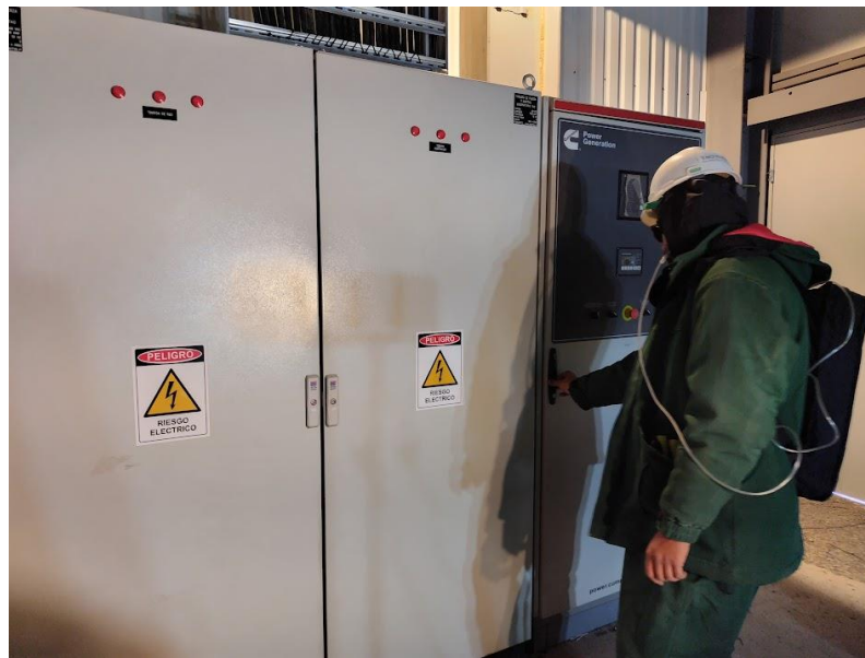
山頂運用棟に設置された配電盤設備
