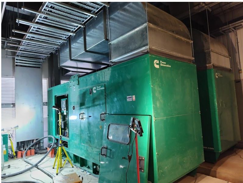
山頂運用棟に設置された370kVA発電機x2
