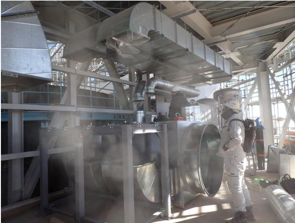
排熱のための大型ファン
