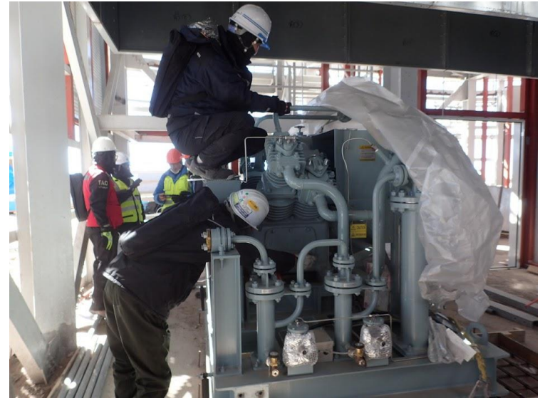
高圧空気コンプレッサー
