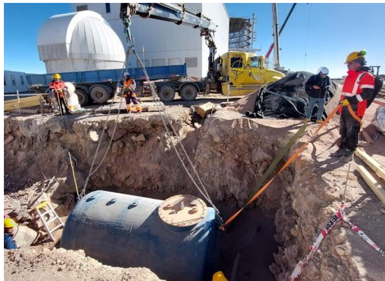
地下埋設中の燃料タンク
